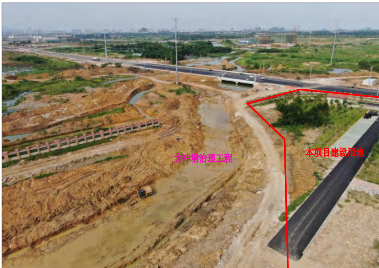
穿过本项目用地的大冲塘治理工程东段施工现状，裸露面积较大
