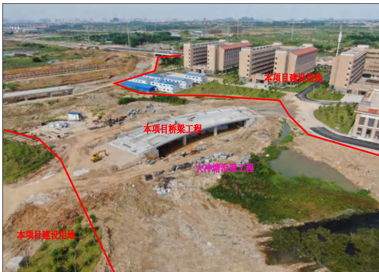
穿过本项目用地的大冲塘治理工程中段施工现状，本项目桥梁工程建设现状，裸露面积较大
