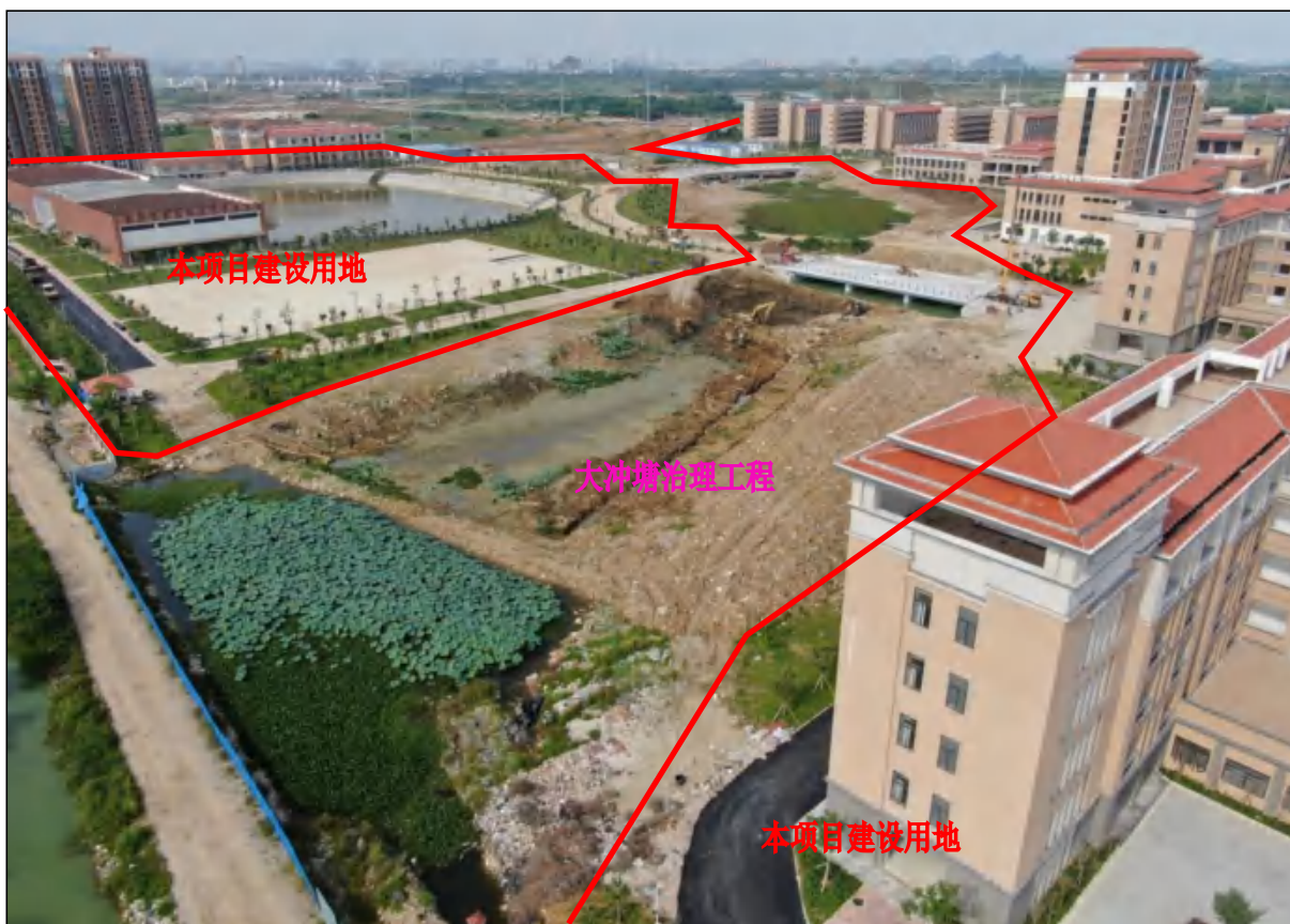
穿过本项目用地的大冲塘治理工程西段施工现状，本项目桥梁工程建设现状，裸露面积较大
