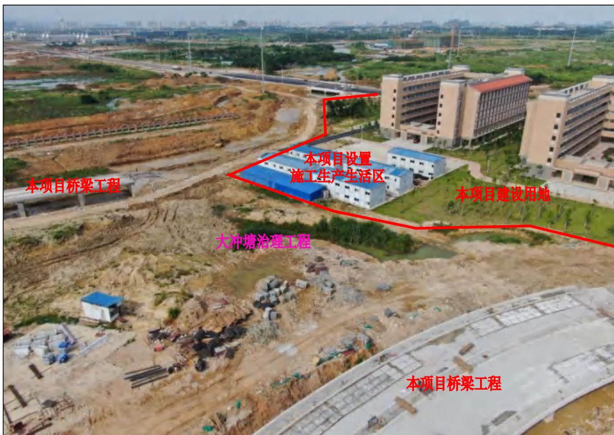
穿过本项目用地的大冲塘治理工程东段施工现状，本项目桥梁工程建设现状，裸露面积较大
