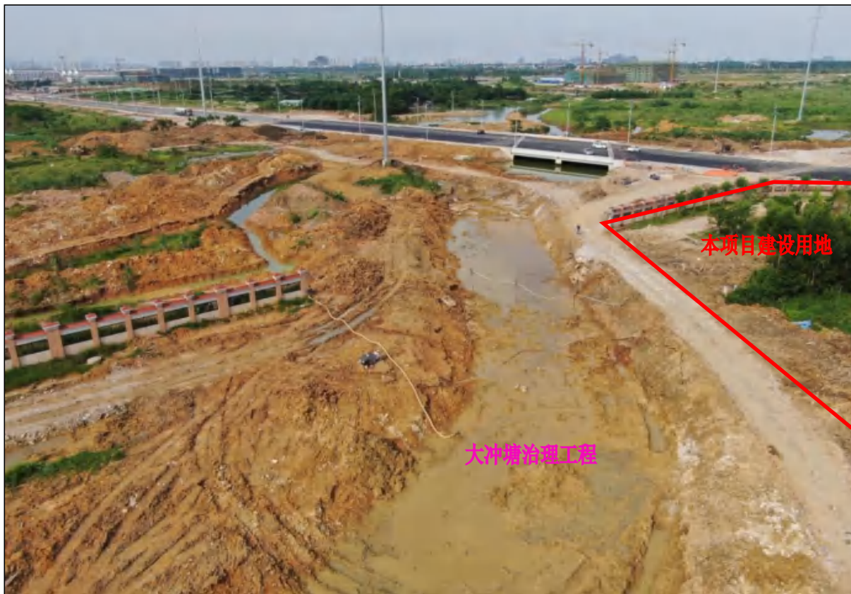
穿过本项目用地的大冲塘治理工程东段施工现状，裸露面积较大
