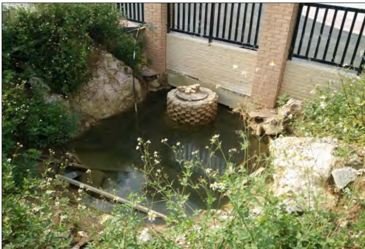
项目用地内南面校区大门外因周边市政排水设施尚未建成，造成雨水淤积的现象
