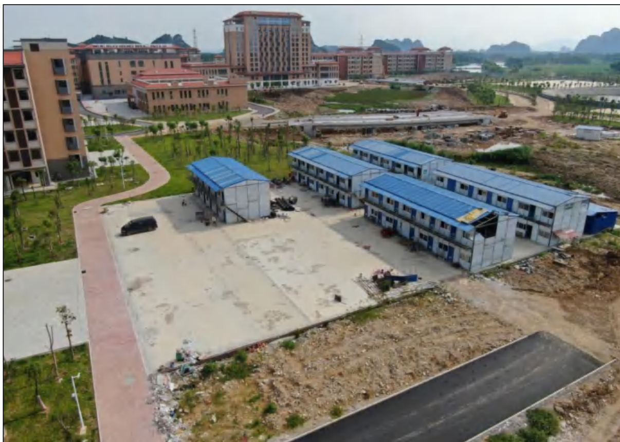
本项目设置的施工生产生活区，位于用地内东北面拟建排球场用地内，现状已硬化
