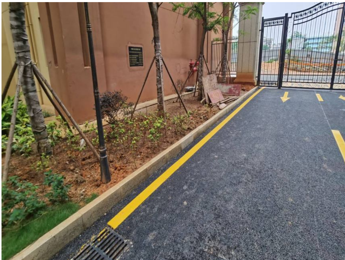
1号楼东面植被生长情况近景图二(靠近东面区段枯死严重)
